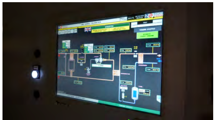
ZE-100-LT Module Control Panel
